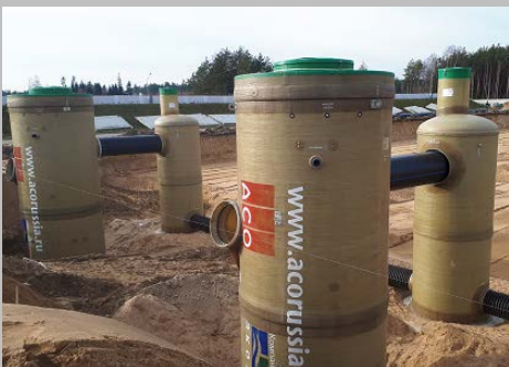
Индустриальный парк "Великий камень" "Оборудование для очистки поверхностного стока в составе ЛОС накопительного типа с самым большим в мире безбетонным аккумулирующим резервуаром АСО StormBrixx, Минск, Республика Беларусь
